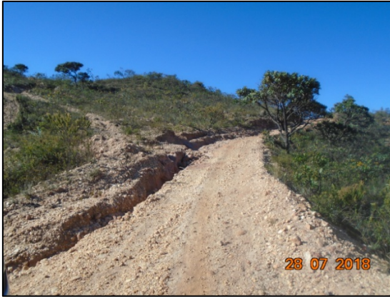
Foto 1.3-31 - Aspecto de acesso de terra precário (destaque para erosão)
