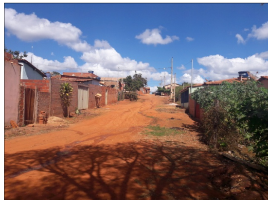
Foto 1.4-6 - Via de terra do Vale das Cancelas, com detalhe ao esgoto a céu aberto
