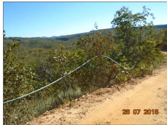
Foto 1.4-9 - Cano de distribuição de água para abastecimento da Localidade rural de Lamarão
