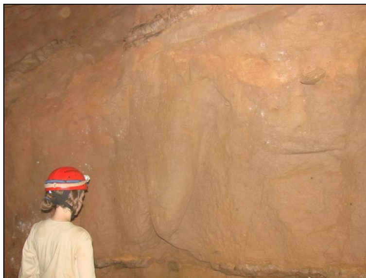
Foto 8.18 - Sulcos nas paredes causados pela percolação de água.
