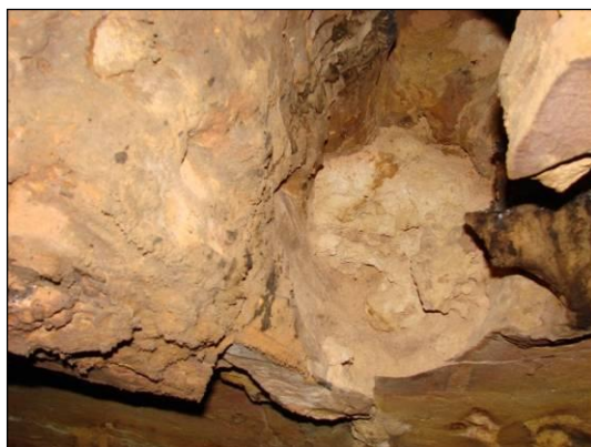
Foto 8.39 - Fratura no teto da caverna preenchida por material de alteração da rocha.
