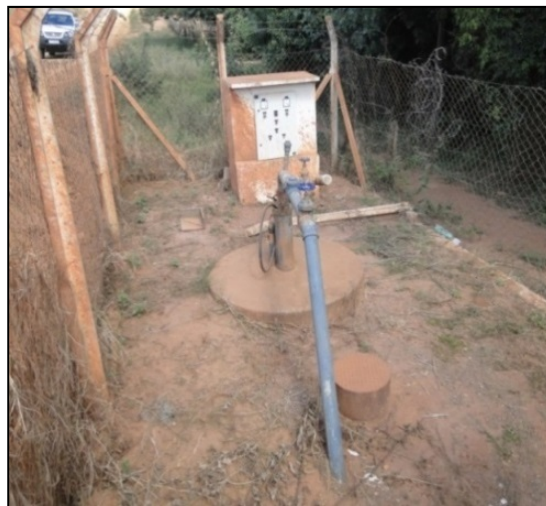
Foto 11.12 - Poço tubular (COPANOR), localizado às margens da estrada na saída de Fruta de Leite para Salinas
