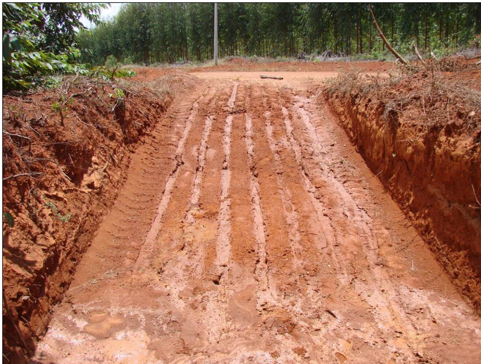
Foto 10.56 - Vala locada na margem de estrada com objetivo de reduzir a velocidade do fluxo superficial
