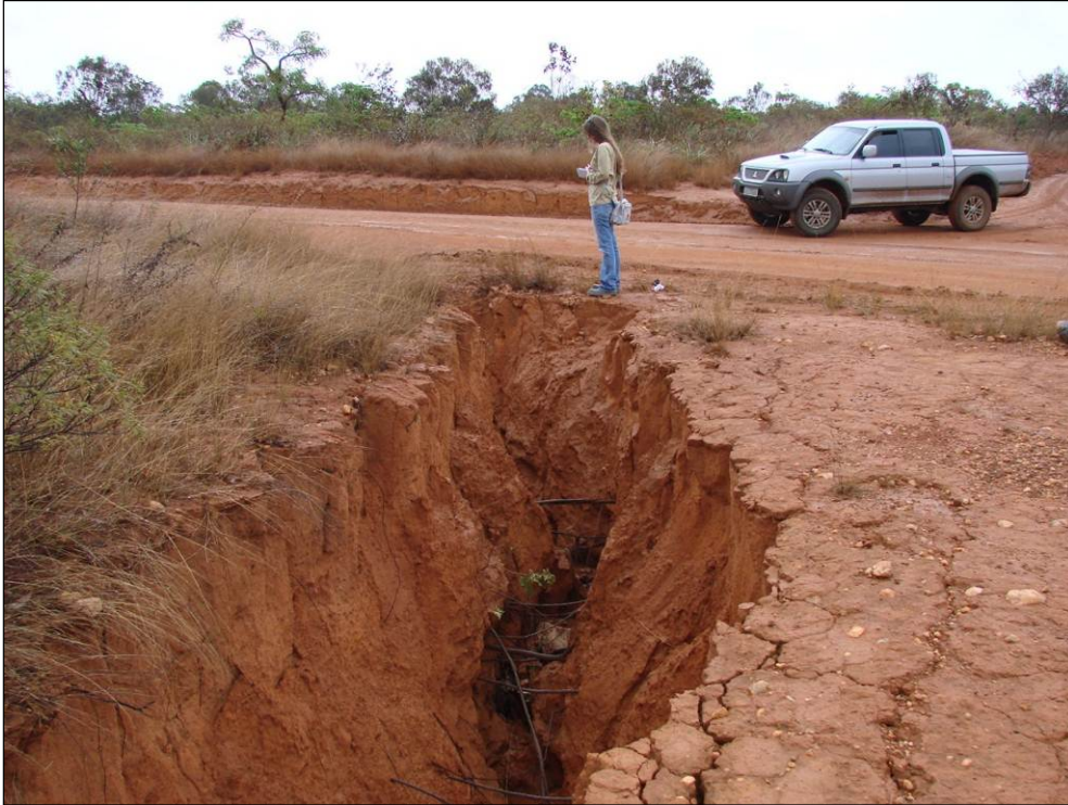
Foto 9.34 - Ravina evoluindo para voçoroca próxima a faixa de servidão da adutora de Irapé e linha de transmissão, desenvolvida sobre Latossolo Vermelho-amarelo
