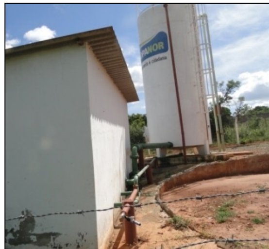
Foto 11.10 - Poço tubular (COPANOR), localizado na extremidade leste de Fruta de Leite
