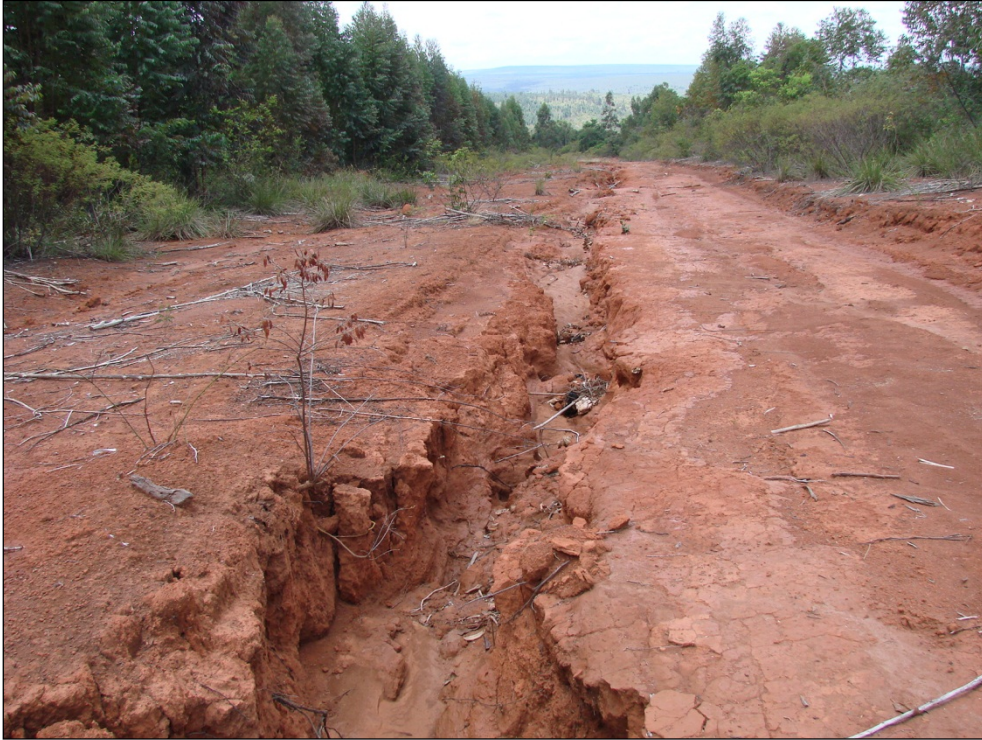
Foto 7.42 - Ravina em estrada que limita eucaliptal, aproximadamente no meio do trecho do traçado
