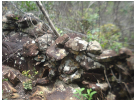
Foto 5.54 - Muro de pedra que se prolonga até o fundo do vale. Coordenadas Geográficas UTM 23K: E 758678 / N 8207358
