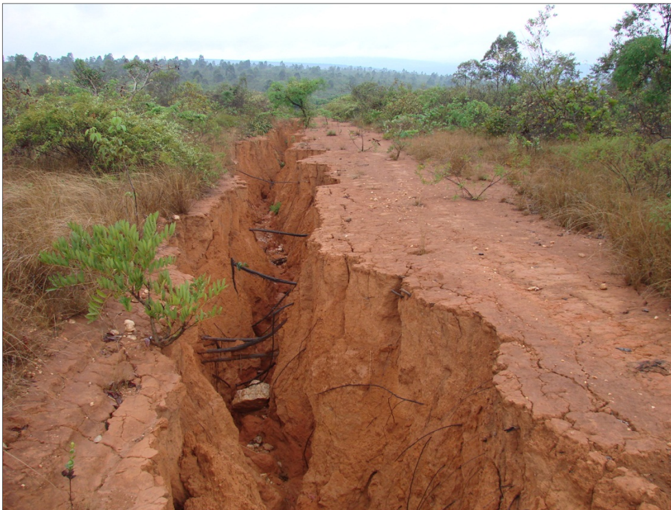
Foto 5.11 - Latossolo amarelo erodido no entorno da área projetada para a instalação da adutora de Irapé e LT
