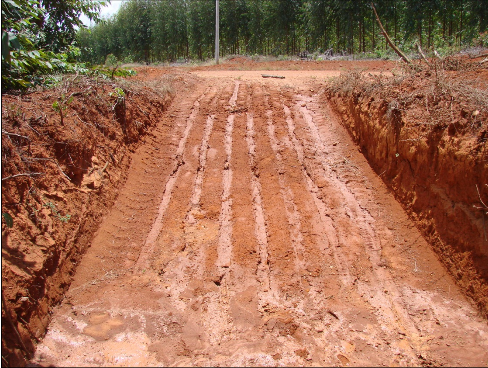
Foto 7.41 - Bacia para contenção do fluxo da água das chuvas, numa gleba onde é realizado o plantio de eucalipto
