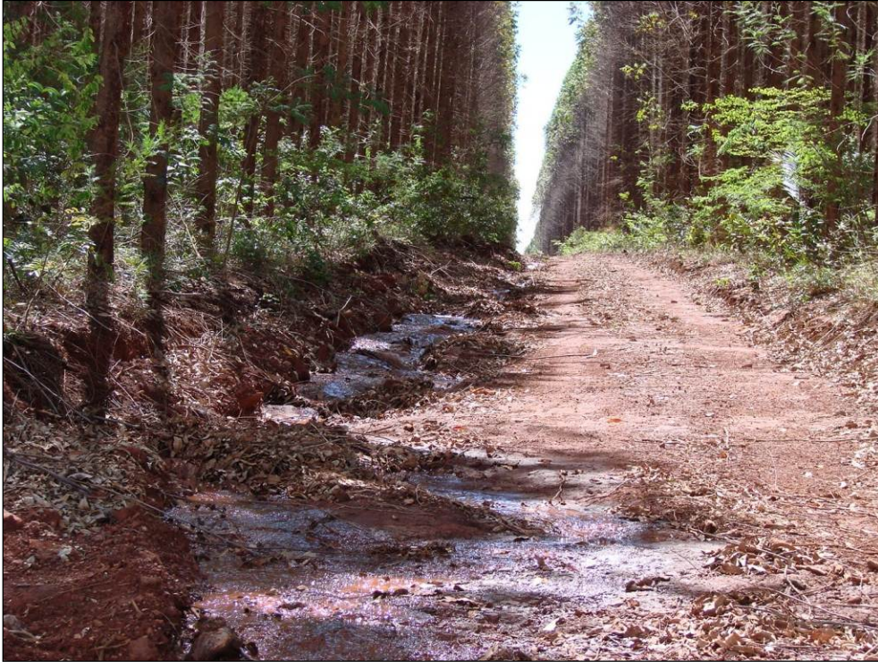
Foto 10.4 - Escoamento da chuva em sulco ao lado de estrada localizada no topo do platô onde se pretende implantar a cava
