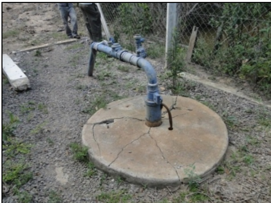
Foto 11.11 - Poço tubular (COPANOR), localizado ao lado do açude da cerâmica
