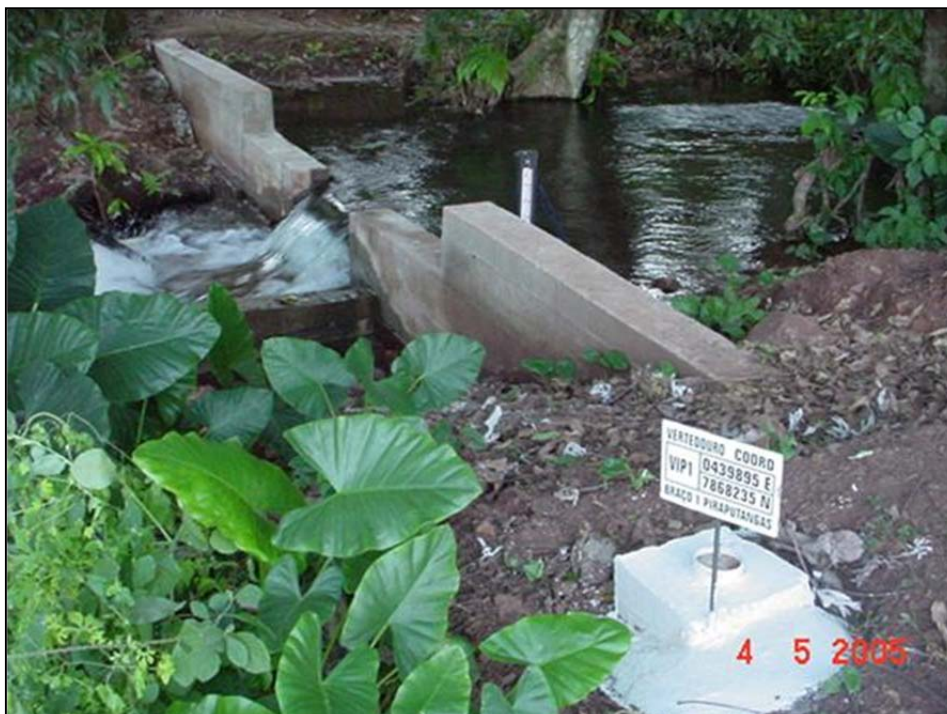
Figura 5.2.1.1 – Vertedouro de medição de vazão.
